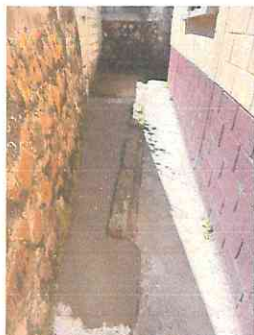
Foto 1: Socavamiento en muro perimetral de 5x1 m.
